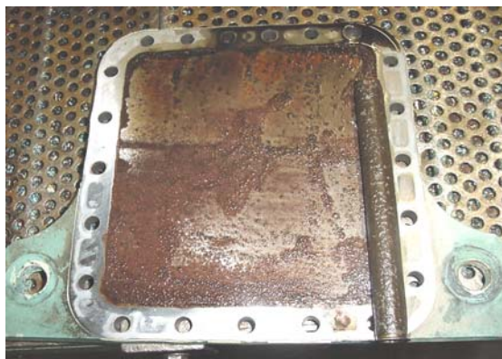
Foto 3 Tampa base de um compressor semi – hermético, ocasião onde “não se trocava” o óleo periodicamente. Havia muitas limalhas provenientes da instalação misturas de óleos não recomendados pela Bitzer. O filtro de arraste de óleo estava completamente entupido.
