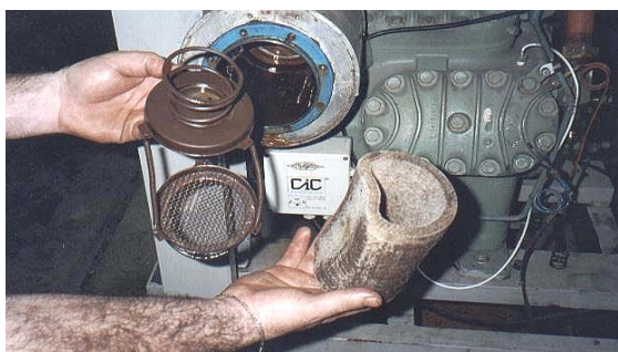
Foto 1 Filtro de sucção tipo feltro “deformado”, não fizeram sua troca no tempo certo, impurezas da instalação passaram pela carcaça e se misturaram com o óleo do cárter.
